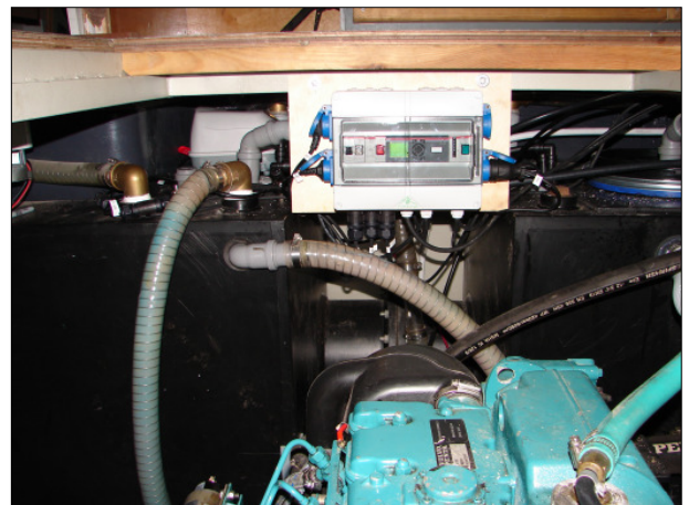
Abwasser- und Belebungsstank mit Anlagensteuerung
