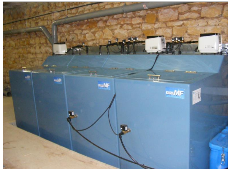
Kläranlage mit Brauchwasserspeicher im Aufstellraum der Schule in Limeuil
