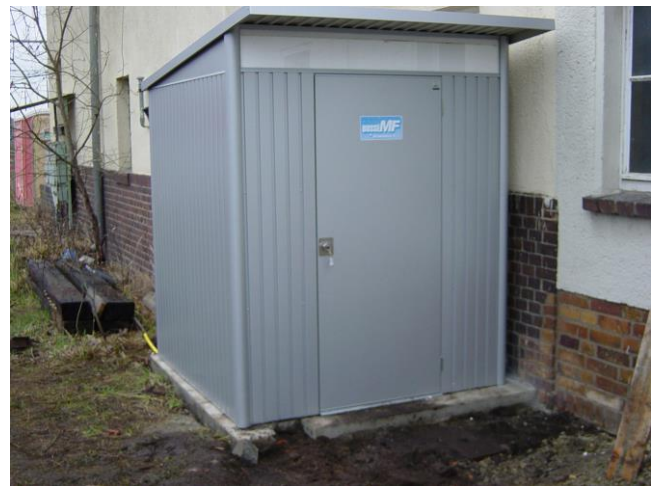
Außenansicht Einhausung der BUSSE-MF im Stellwerk Schwarzkolim
