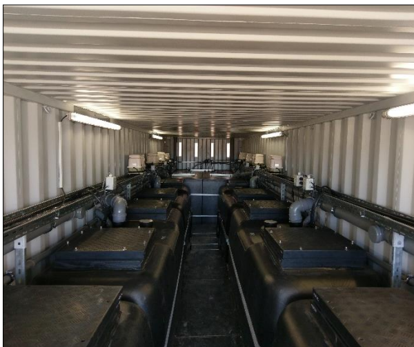
Blick ins Innere des Containers. Im Inneren sind die Membranbioreaktoren mit der dazugehörigen Technik untergebracht.
