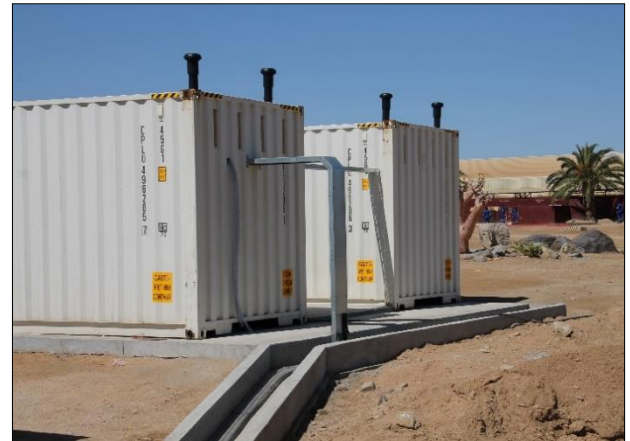
Außenansicht Container-Anlage bestehend aus 2 x C100
