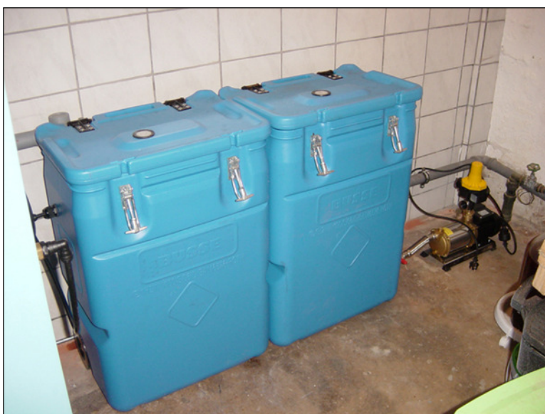
Brauchwasserspeicher 300 L, Hauswasserautomat
